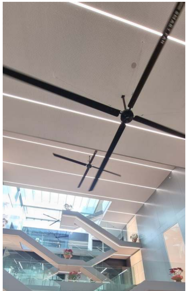
Sistema de ventilació a Aitex
