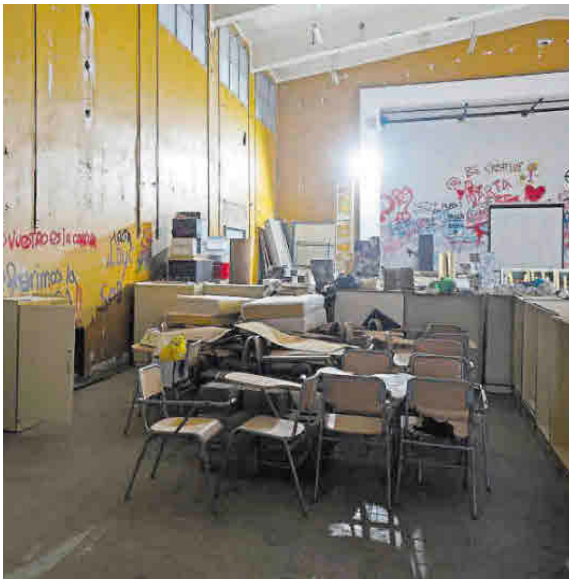
Estado del salón de actos del IES Cid Campeador que lleva 20 años esperando su rehabilitación.
