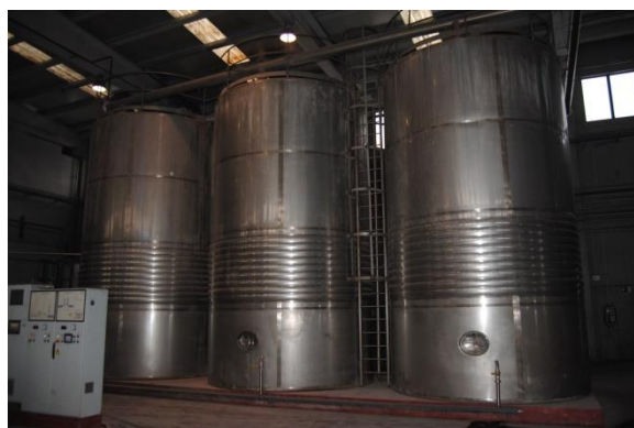
Imagen: Depósitos disociadores
