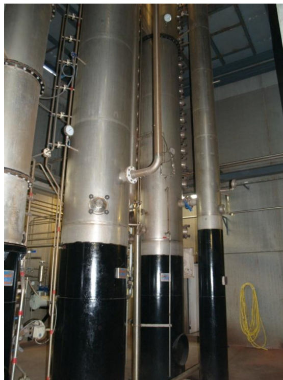
Imagen columnas de rectificación
