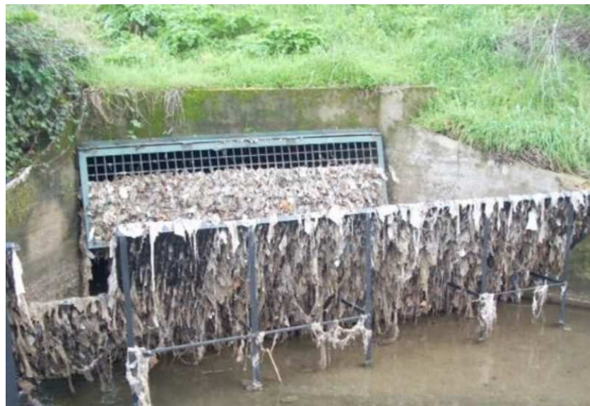
Desagüe colapsado por toallitas
