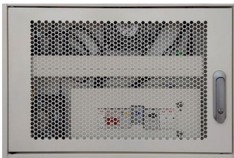
Figura 2-11 Puerta de cuadro eléctrico
