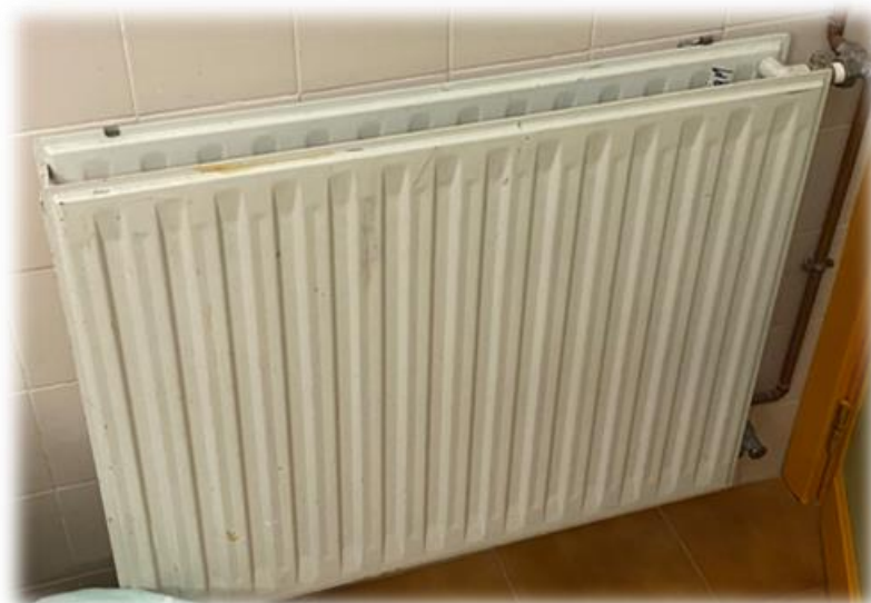
Il·lustració 2. Radiador per a la calefacció de la zona antiga.
