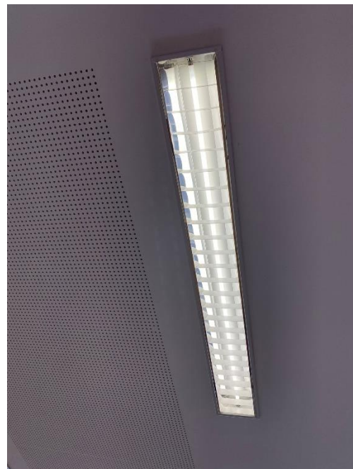
Ilustración 7. Iluminación con tubo LED en aulas.
