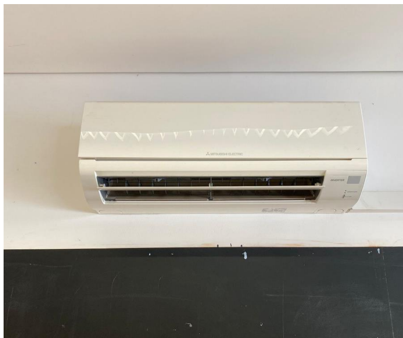
Ilustración 1. Dispositivo de aire acondicionado en una de las aulas.
