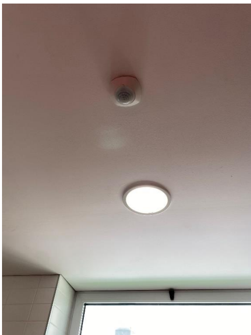
Ilustración 6. Iluminación con bombilla LED y detector de movimiento en baños.
