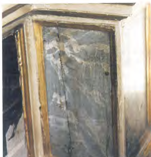
Desencolados y grietas.
