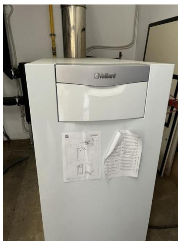
Ilustración 7. Fotografías representativas de la instalación de calefacción
