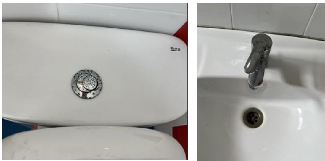
Ilustración 9. Instalación representativa de la instalación de agua
